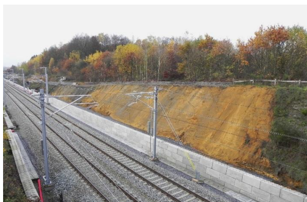
Photo 10. – Talus profondément remanié et très pentu, avec installation d'un mur de blocs de béton à son pied (8 novembre 2015).
