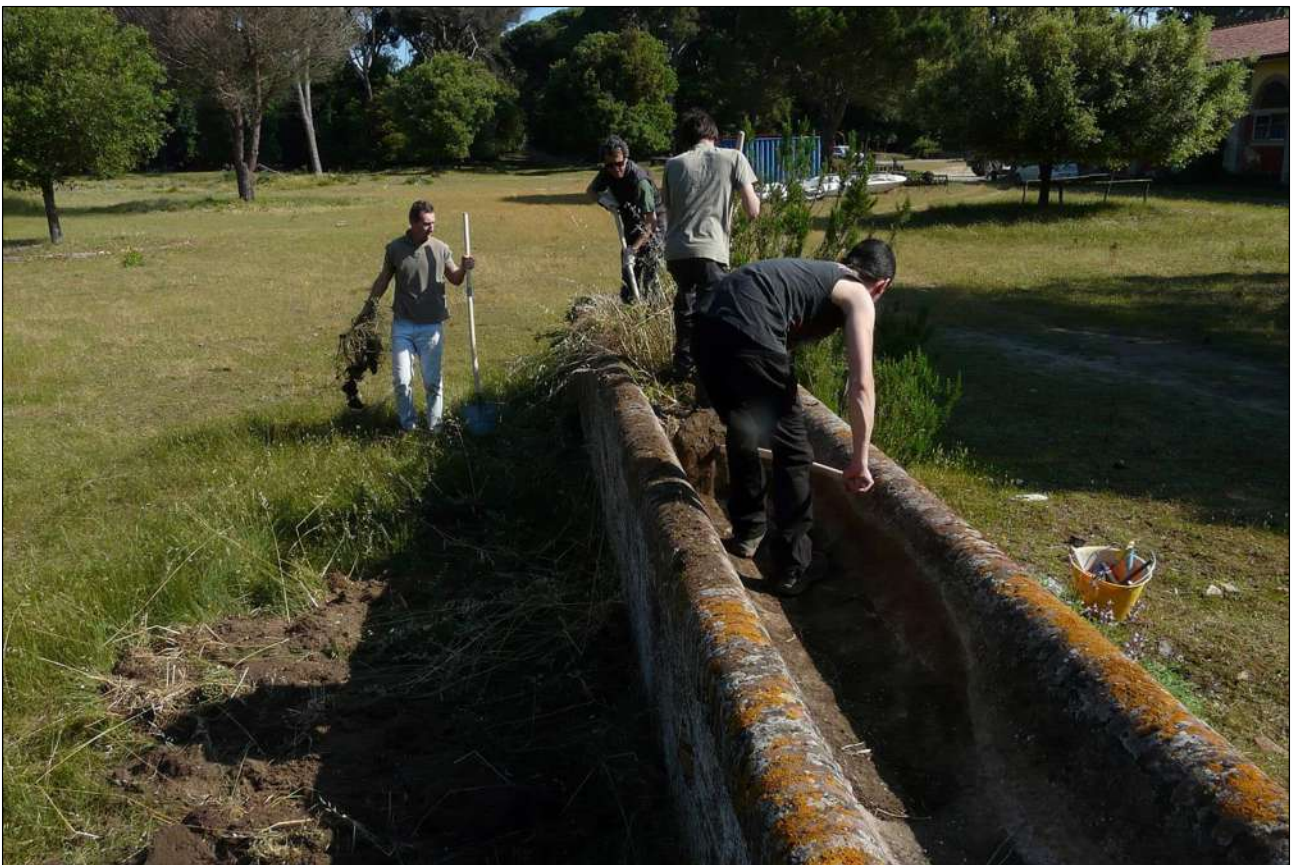
Figura 5.54 Rimozione della terra, della vegetazione e dei detriti all'interno di un abbeveratoio.
