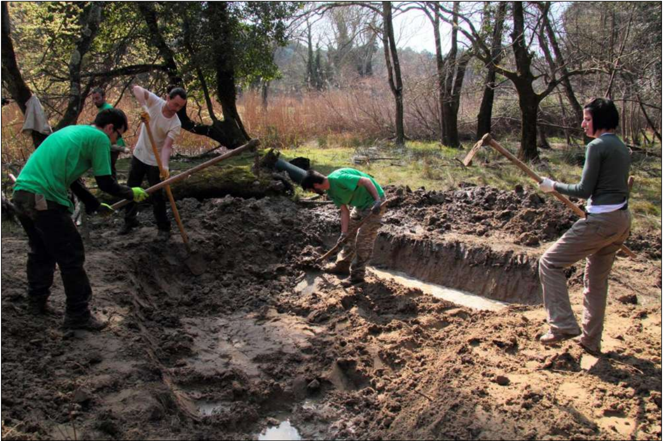
Figura 5.48 Gli operatori durante le fasi di scavo e approfondimento del futuro stagno.
