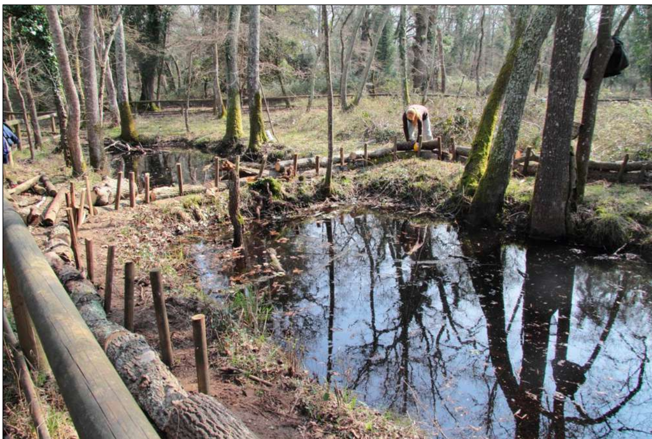
Figura 5.42 Il posizionamento dei paletti sui quali verrà successivamente fissata la rete protettiva.
