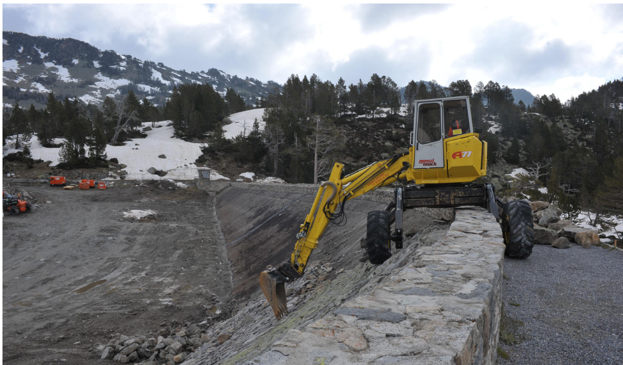
Les travaux de réfection du barrage d'Aubert, ayant nécessité de temporairement déplacer la population locale d'I. bonnali
