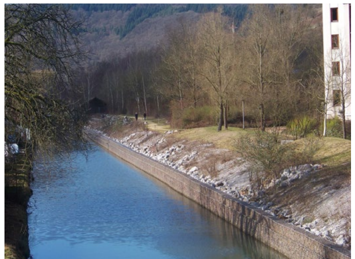
Abb. 6 – Sanierter Kanal der Schleuse Bad Ems, zuvor Biotop für Zaun- und Mauereidechsen, dann 2009 saniert und ohne Pflanzen, II.2015
